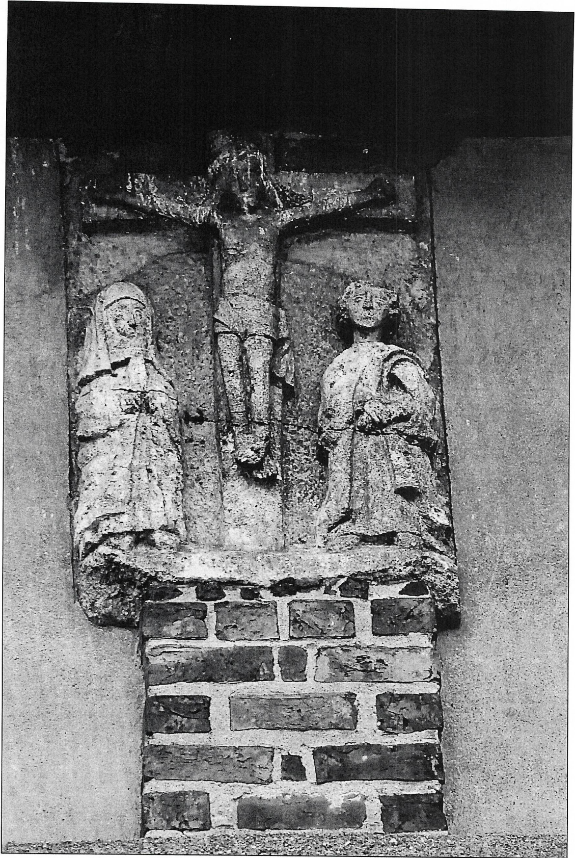
Fot. 3. Fasada kościoła pw. Św. Mikołaja w Stawie. Płaskorzeźba Ukrzyżowanie . Stan z 20.01.2023 r. Widoczne pęknięcie kamienia w połowie. Figura Ukrzyżowanego zabrudzona odchodami gołębi. Na powierzchni widoczne uzupełnienia z wcześniejszych napraw.
